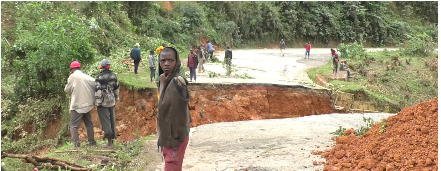
Effondrement de la route entre Bugarama et Muramvya
